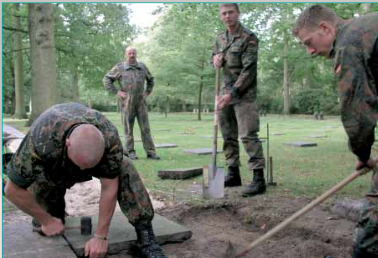
Ein Dutzend Wehrpflichtige und Zeitsoldaten vom 4./Panzerpionierbataillon 801 aus dem brandenburgischen Storkow reisten vergangenes Jahr 900 Kilometer nach Belgien, um dort 900 schwere Betonplatten zu verlegen. Auf diesen fachmännisch verlegten Steinen wandern heute die Besucher der deutschen Kriegsgräberstätte Vladslo, wenn sie die über 25 000 Gräber des Ersten Weltkrieges besuchen.
